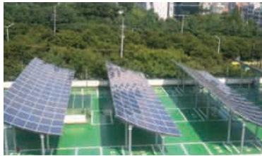
주차장 태양광 발전 시설 전경(계명대)
