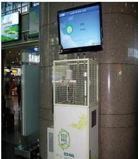
지하도상가 내 실내공기질 전광판 설치 현황
